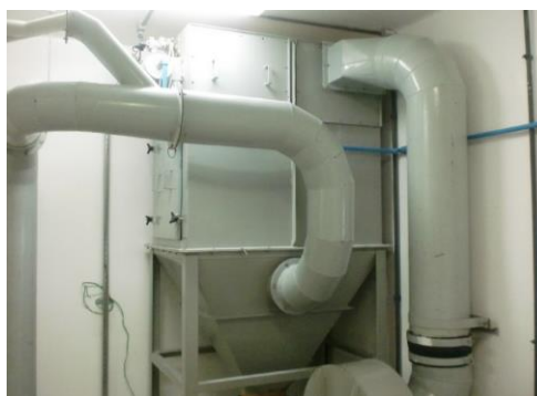
Figura 7 - Sistema de exaustão
